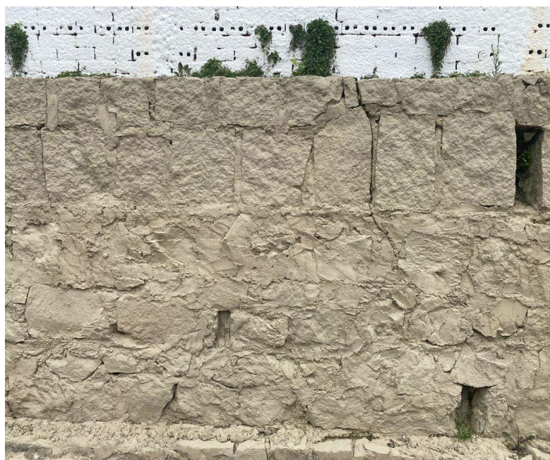
24| Detalhe de muro de arrimo em pedra e alvenaria. Constar-se diversos pontos de inclinação direcionada ao lote ao longo do comprimento do paramento.
