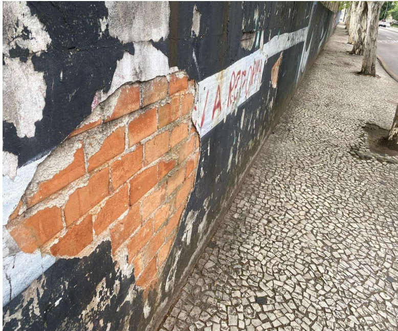
10| Deslocamento de reboco em lado externo do muro situado no alinhamento predial da Rua Luiz Leão.
