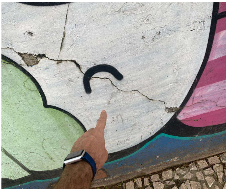
15| Rachaduras em lado externo do muro situado no alinhamento predial da Rua Luiz Leão.
