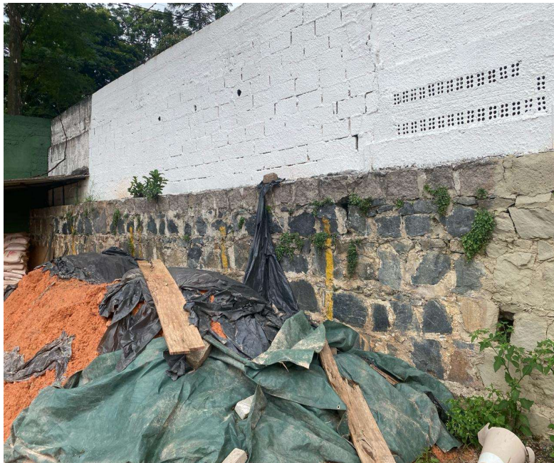
21| Vista interna de muro de arrimo em diversos pontos com inclinação direcionada ao lote
