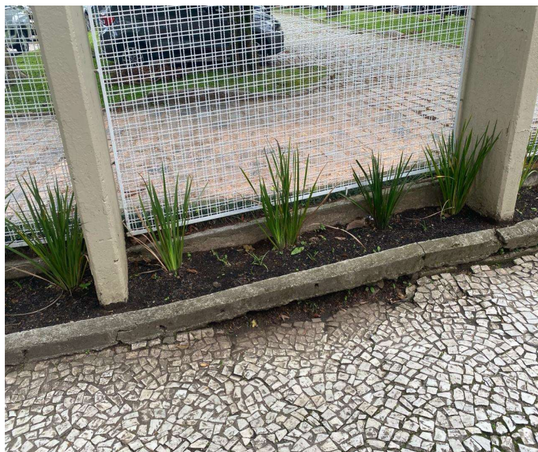
29| Recalque de passeio de pavimentação em pedras em via pública (Rua Luiz Leão).
