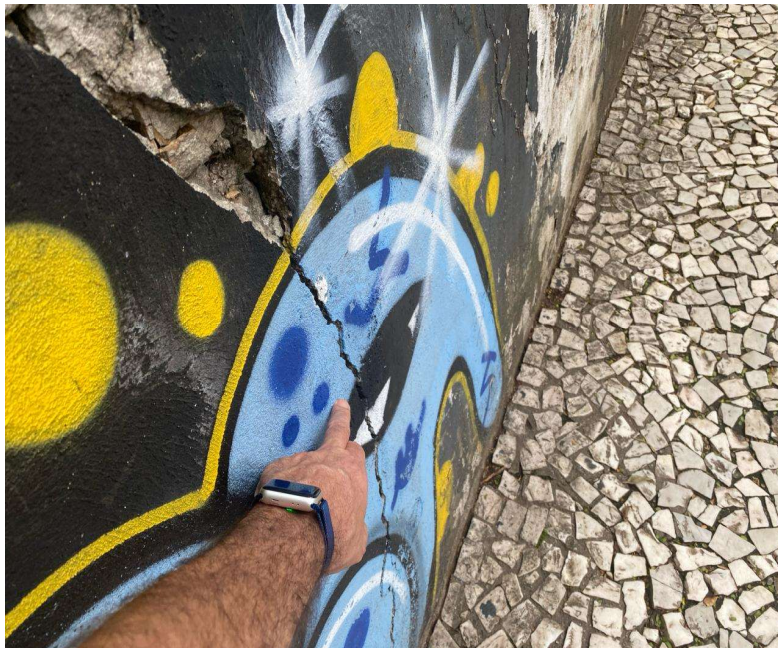
11| Rachaduras em lado externo do muro situado no alinhamento predial da Rua Luiz Leão.
