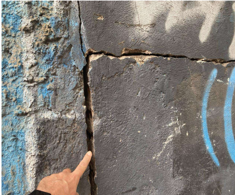
14| Rachaduras em lado externo do muro situado no alinhamento predial da Rua Luiz Leão.
