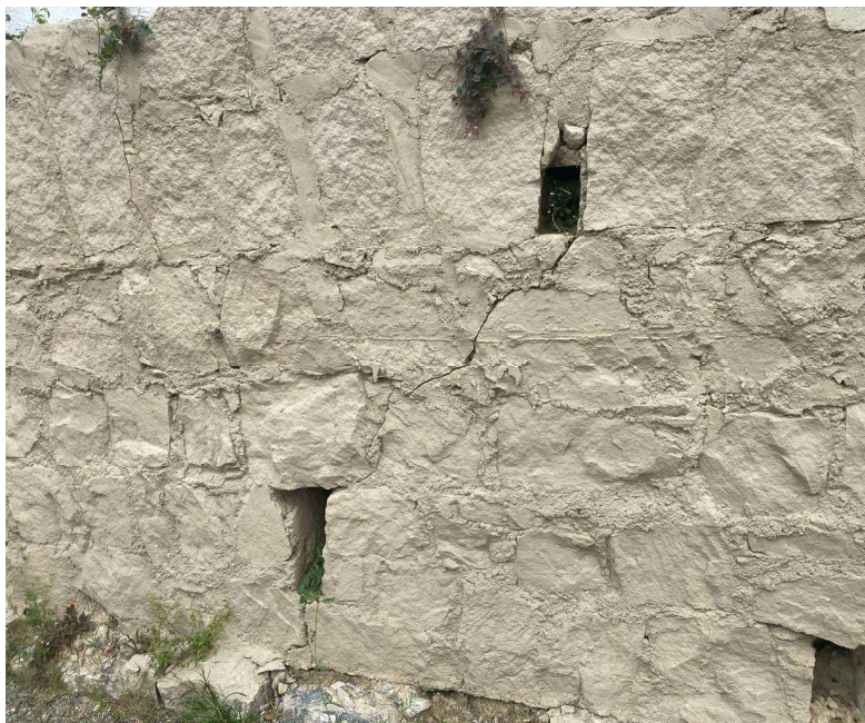
25| Vista interna do muro de arrimo vistoriado com rachaduras e recalques.
